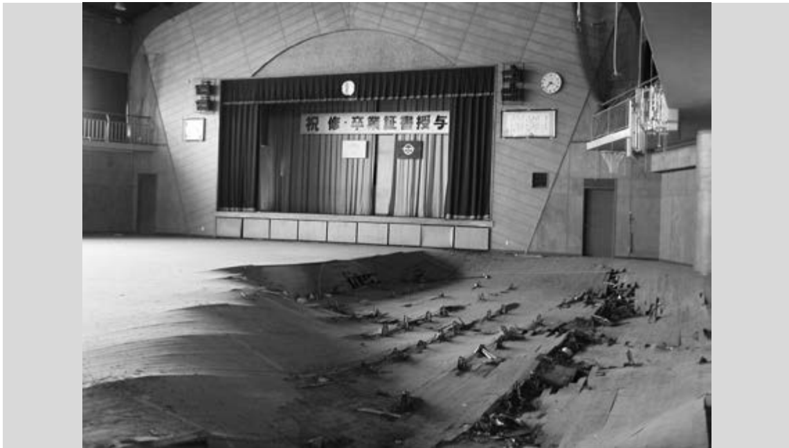
床の抜けた請戸小学校の体育館
